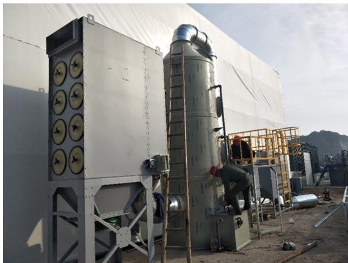
图 4-6 密闭大棚尾气处理系统实景图
